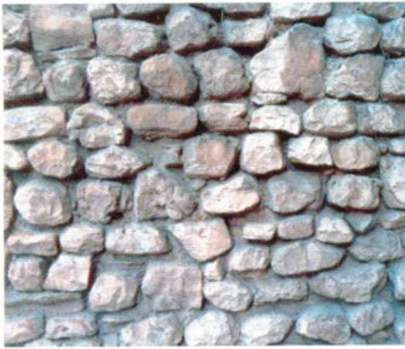
Fig. 1 - Muratura in pietraforte fortemente degradata per erosione e decoesione dei giunti di malta. Il degrado avanzato delle malte può provocare il distacco dei blocchi lapidei con instabilizzazione e caduta degli stessi.
