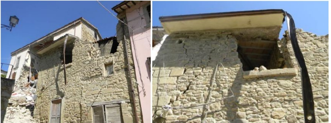
Fig. 10. Disgregazione di un edificio in muratura (da [3])
